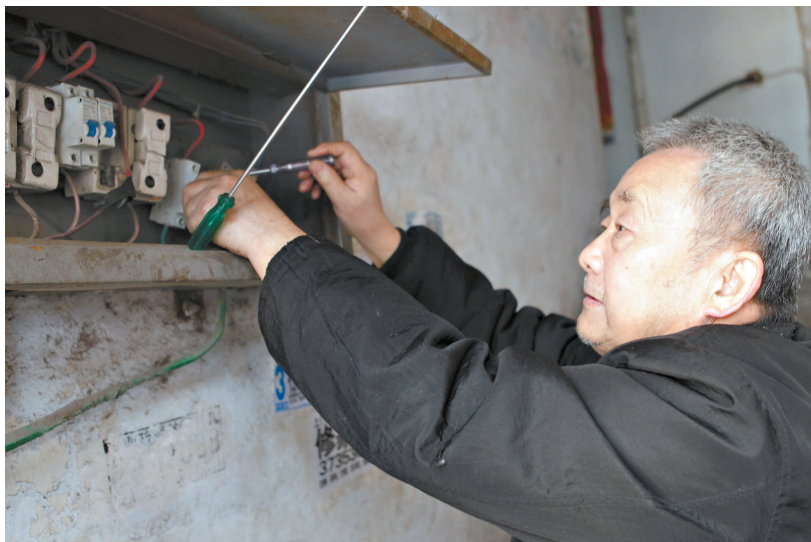
11月18日,住宅楼内的电路出了毛病,赵作民又成了义务维修工。
