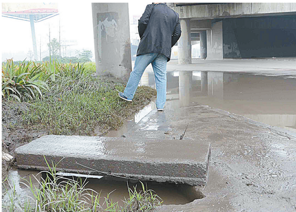
10月30日上午,市区建设路东段立交桥下出现的无盖窨井,污水横流导致路人难行。
