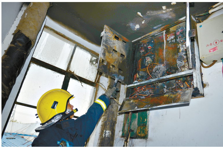
消防队员查看被烧得面目全非的电表箱。
