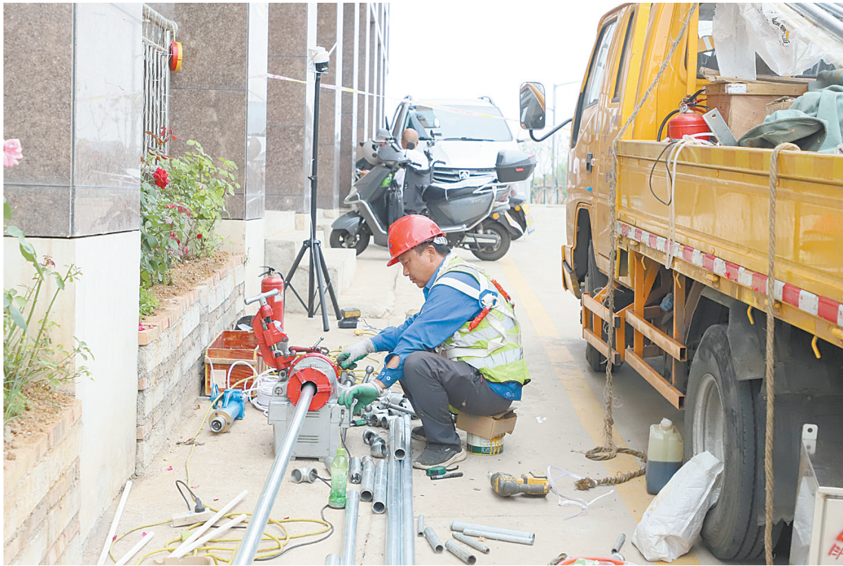
6月9日，在示范区佳田西湖岸小区附近，平燃智家综合服务有限公司的施工人员为一家餐饮店进行“瓶改管”施工。
