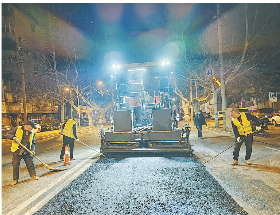
修路工人在市区光明路与湛河南路交叉口附近整修破损路面
