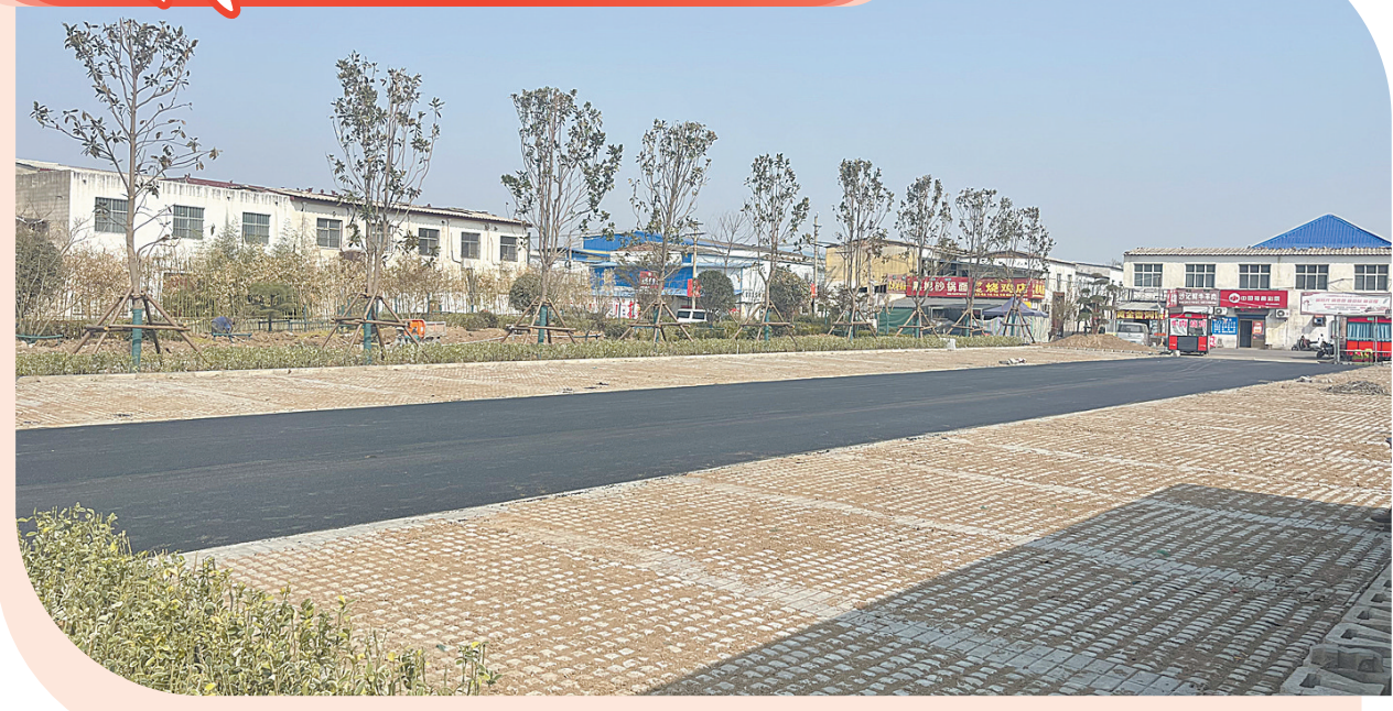
3月25日,焦店村主街西侧的停车场修整完毕,即将投入使用。 本报记者 毛玺玺 摄
