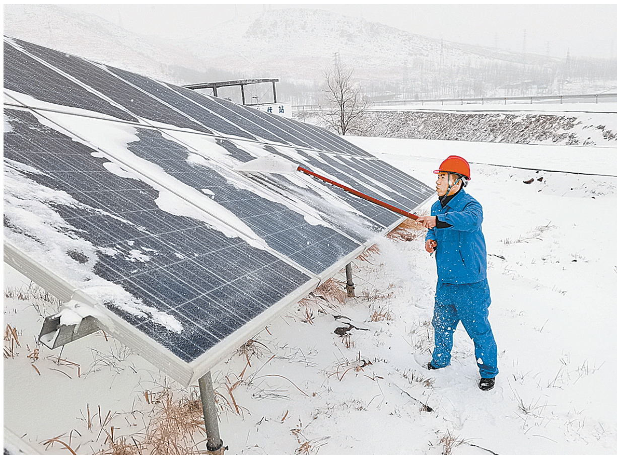
2月21日,中国平煤神马天源新能源公司花山光伏电站运维工在清理积雪。
