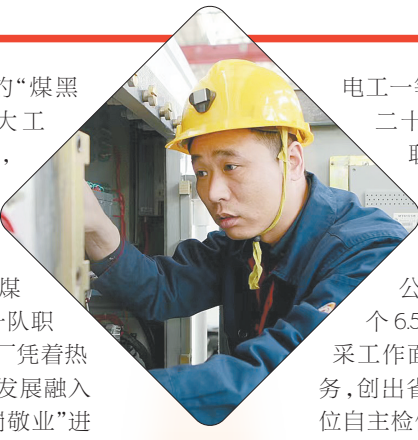
张工厂在检修高压组合变频器开关
