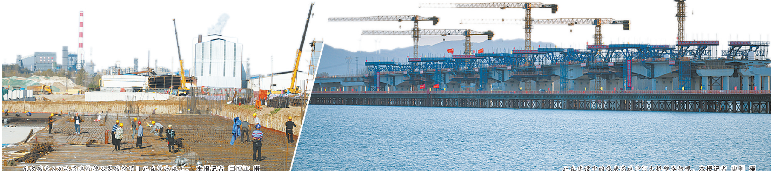
东方碳素3万吨高端特种石墨碳材项目正在紧张施工。本报记者 闫增旗 摄
