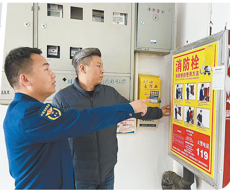
王帅可(左)在检查消防设施
