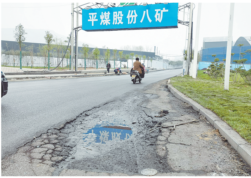
平安大道与八矿路交叉口附近的八矿路部分路面损坏,存在凹坑。
