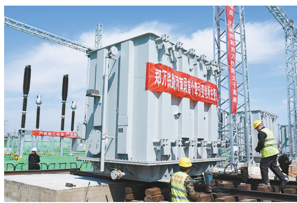
2019年3月11日,郑万铁路河南段首个牵引变电站所主变在宝丰安装就位。
