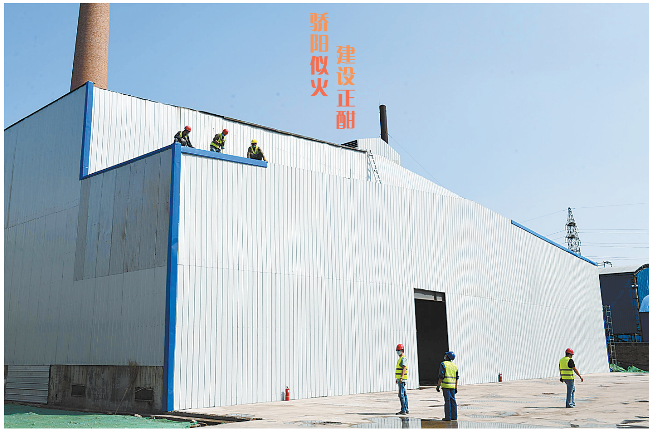
5月30日,阳光炙热,施工人员在平顶山艾普化工有限公司化工新材料厂房加紧施工。
