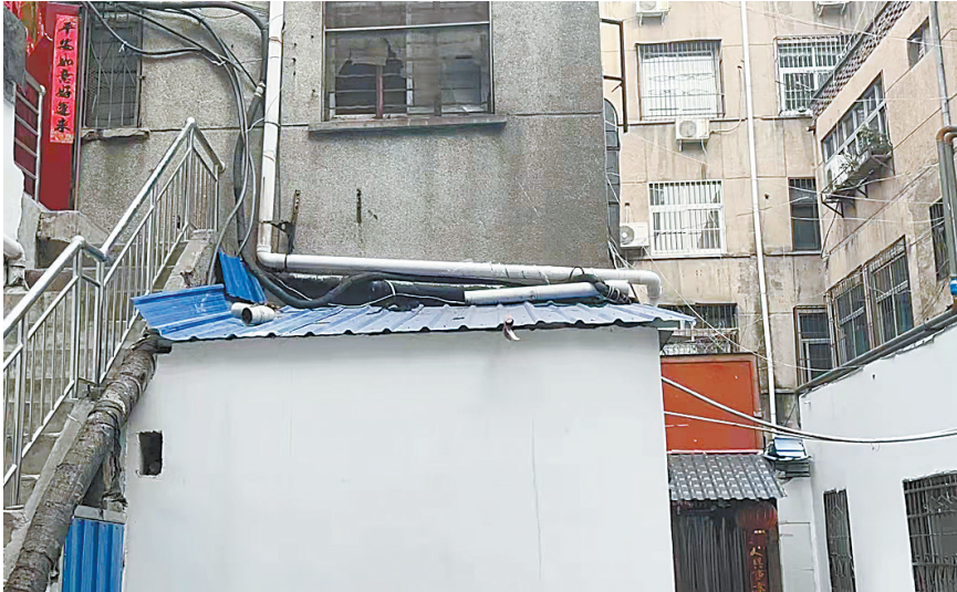
往家属院空地排水的管道已整改
