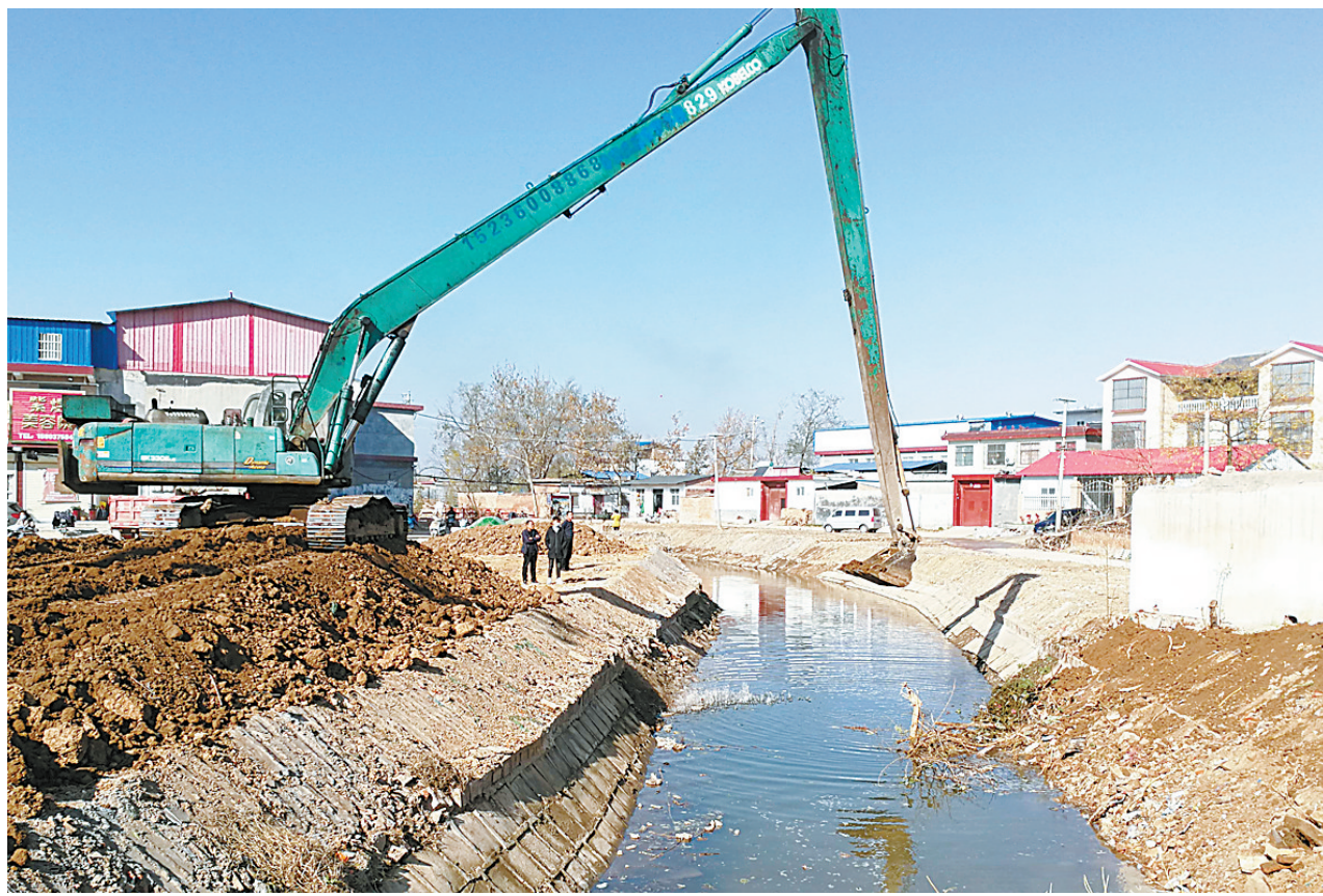
11月25日,施工人员在白龟山水库坝外排水沟曹西村段用大型机械整理边坡。 湛河区今年5月启动了曹镇乡白龟山水库坝外排水沟治理工程,该工程将对9.64公里的坝外排水沟进行清淤
