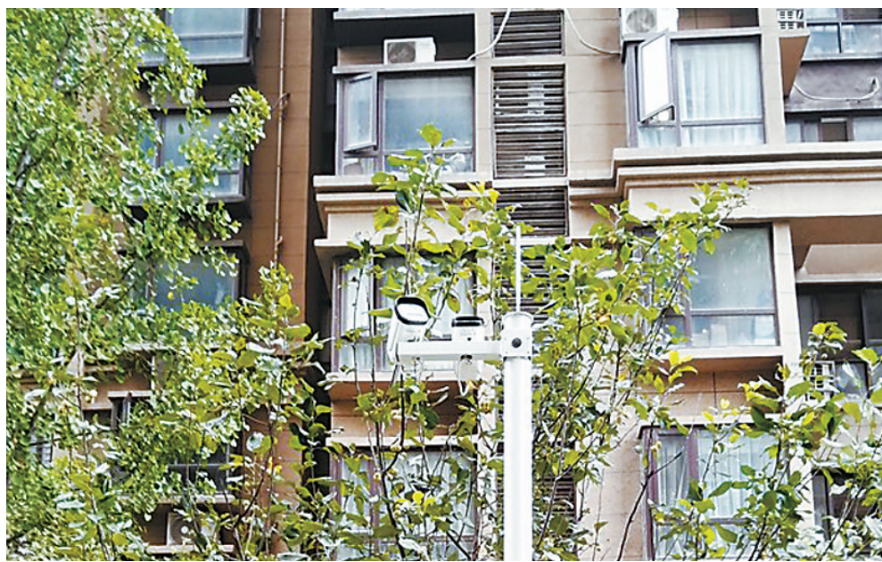
安装在百合金山小区内的高空抛物监控系统
