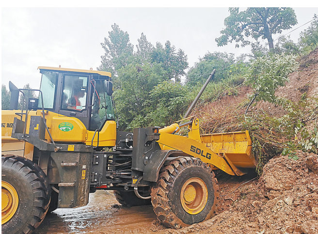
7月21日,在国道207鲁山县四棵树乡黄沟村附近,县公路事业发展中心工作人员正用铲车清理山体塌方。20日凌晨1点,此处山体塌方,经过连夜清理,没有影响交通运行。21日此处出现二次塌方,该中心再次调来铲车清理。本报记者 常洪涛 摄
