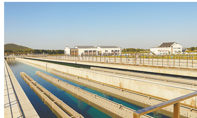
焦庄水厂平流沉淀池
