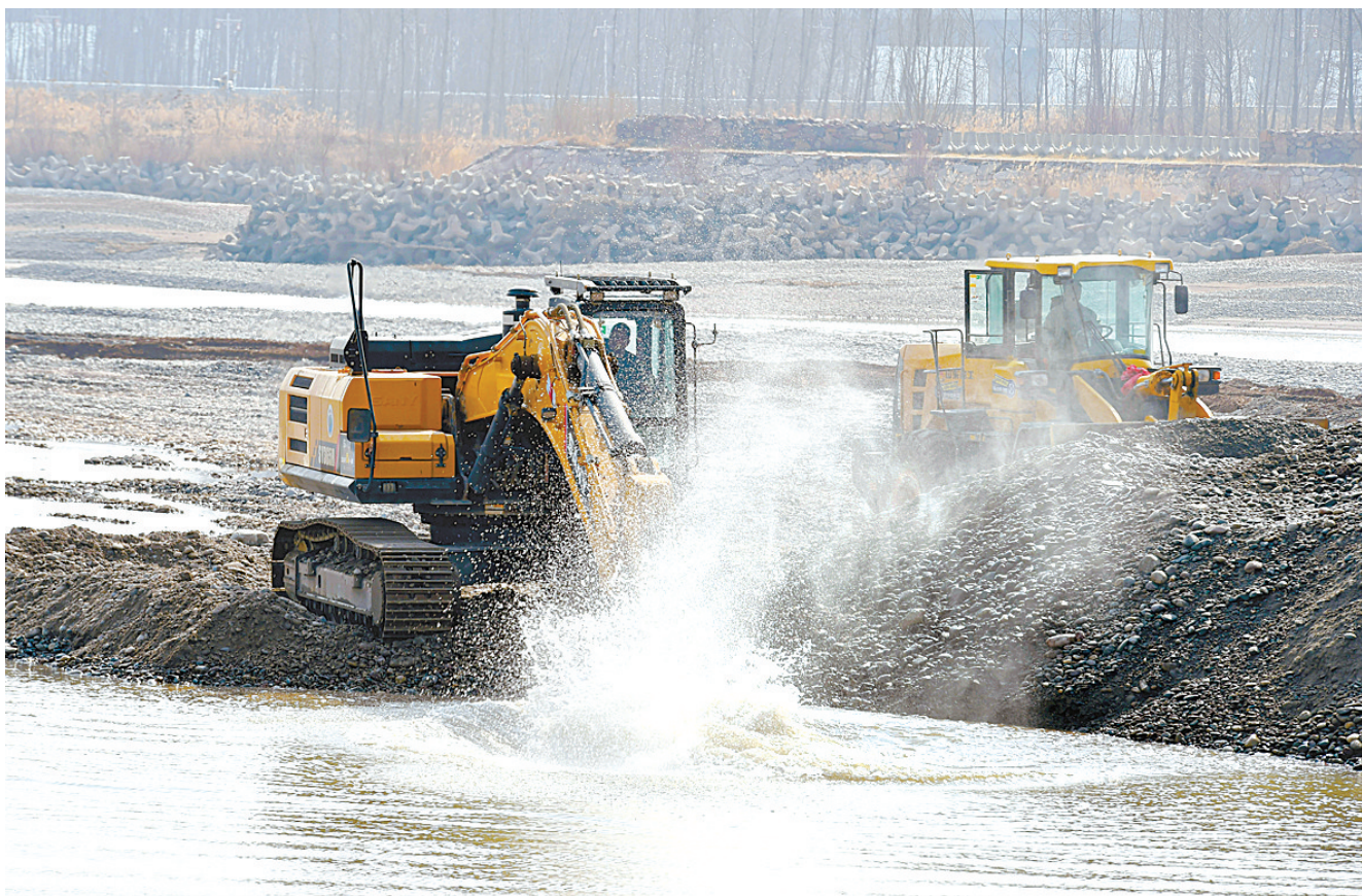
黄河河道清淤疏浚忙 2月25日,在黄河宁夏中卫市沙坡头枢纽至中卫市水利部门对黄河宁夏中卫市沙坡头枢纽至中卫市白马乡段河道开展大规模疏浚清淤作业,以确保今年该段河道安全行洪和船舶航行畅通。 此次工程投入各类机械200多台,挖泥船两艘,工程人员350多人,预计3月20日前完成。 新华社记者 唐如峰 摄
