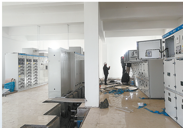
水厂配电间设施配套到位
