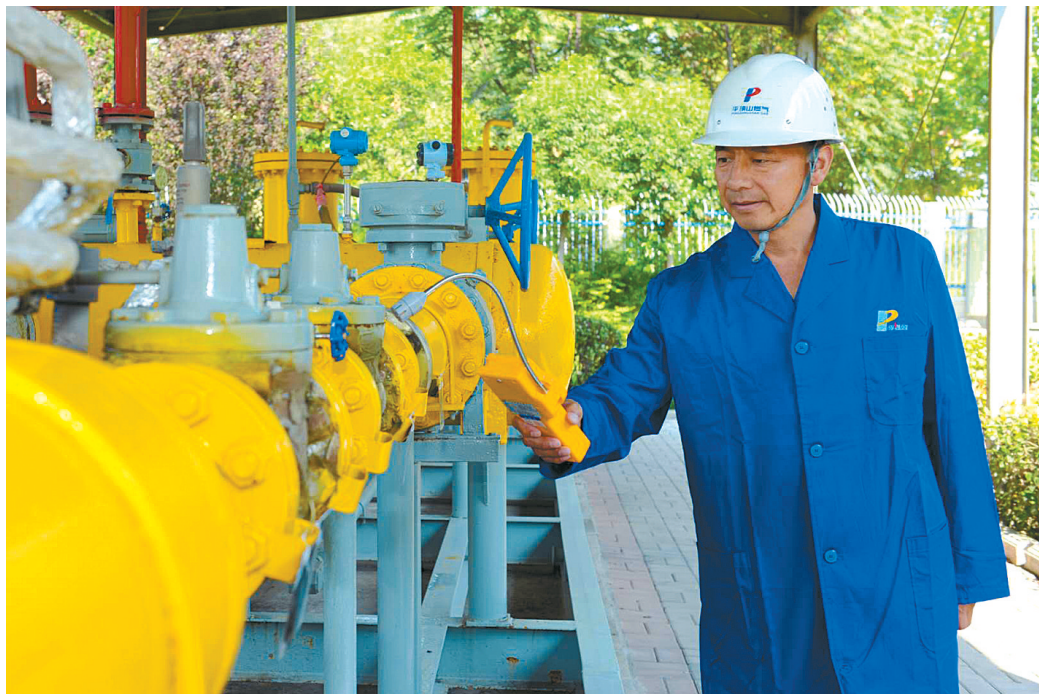
9月10日上午，肖卫兵在新城区调压站检测设备运行情况。
