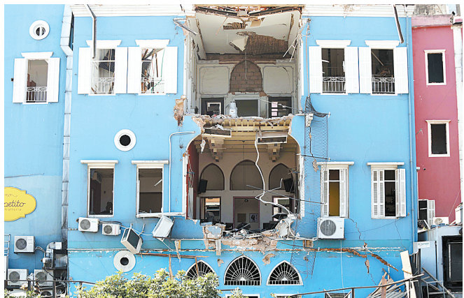
这是8月5日拍摄的在爆炸中受损的居民楼。新华社发
