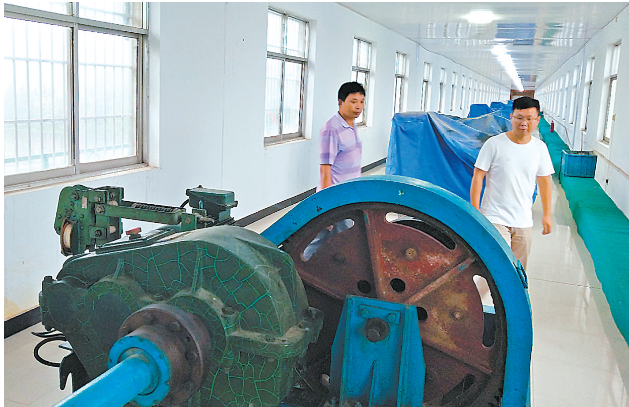
7月19日，田岗水库管理局工作人员在对泄洪闸门机电设备进行日常检查。
