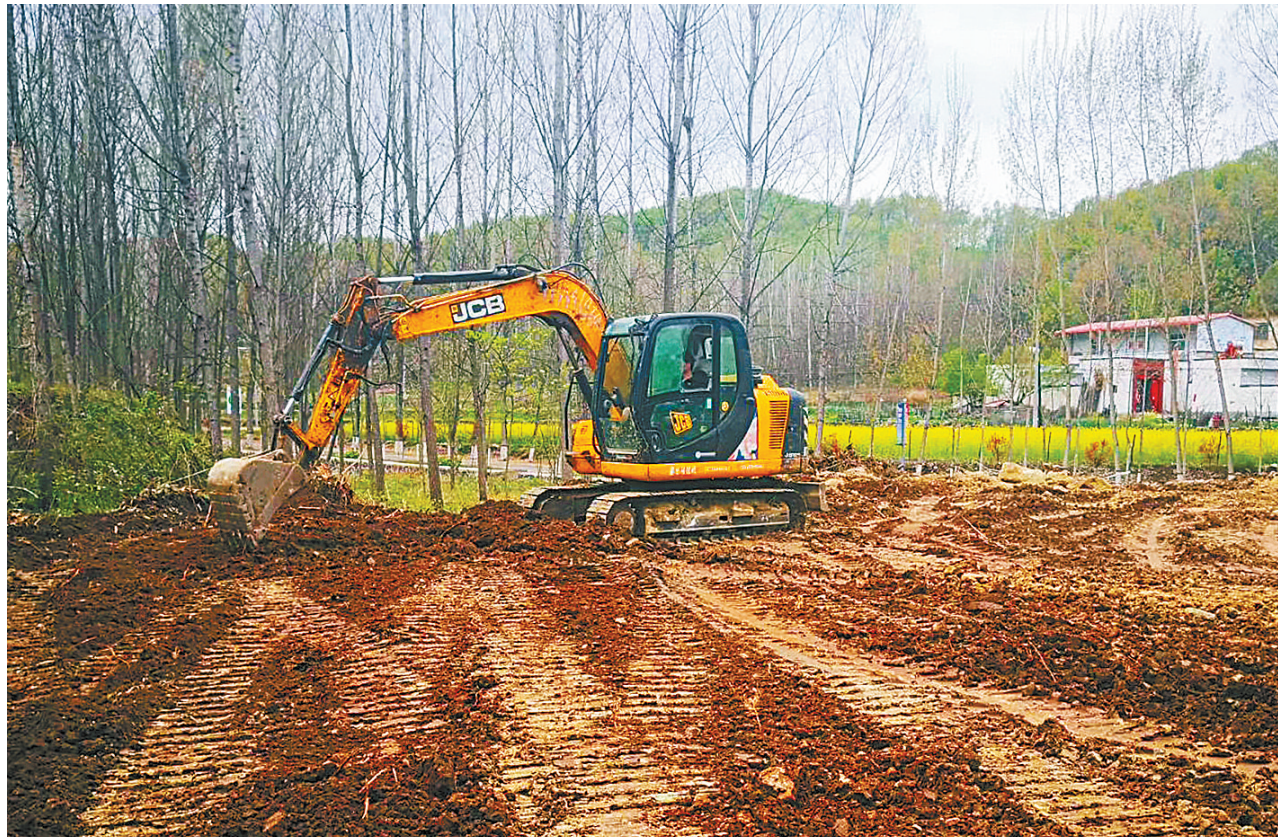
建设民宿项目 4月7日，工人驾驶挖掘机在鲁山县四棵乡黄沟村民宿园施工现场平整地基。
