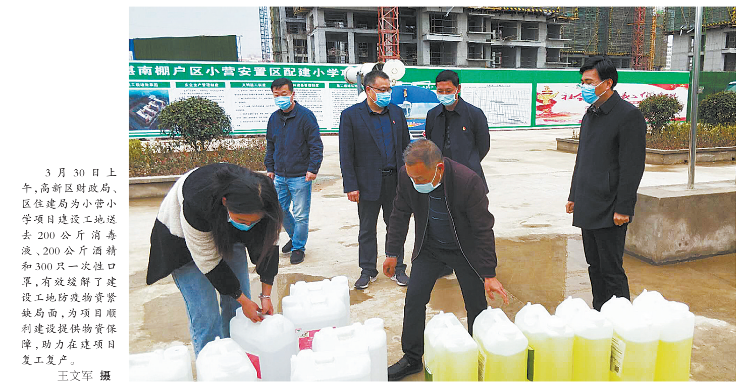
3月30日上午,高新区财政局、区住建局为小营小学项目建设工地送去200公斤消毒液、200公斤酒精和300只一次性口罩,有效缓解了建筑工地防疫物资紧缺局面,为项目顺利建设提供物资保障,助力在建项目复工复产。王文军 摄
