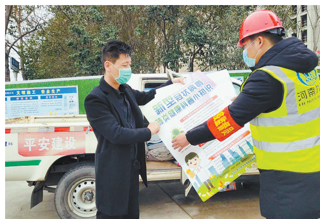
3月9日,新华区住建局工作人员、“首席服务官”王晓广(左)在位于焦店镇焦店村对面的西城国际十里画廊项目施工现场,与该局派驻在工地的监管员交流,指导复工工作。 毛玺玺 摄
