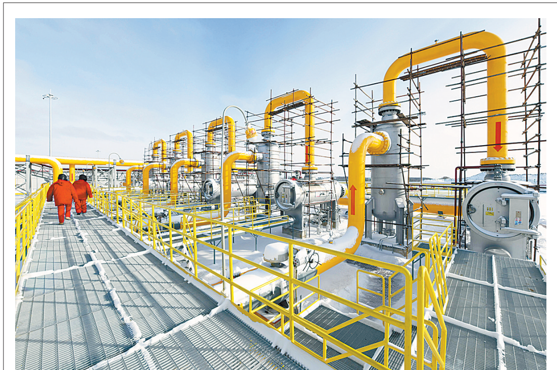
俄罗斯天然气通过中俄东线天然气管道正式进入中国。图为工作人员在中俄东线天然气管道北段黑河首站场区巡检(11月19日摄)。新华社记者 王建威 摄
