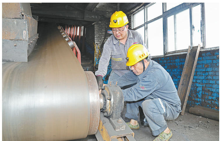
为减轻职工劳动强度,提升皮带运量,缩短装车时间,一矿储运队对运装设备进行升级改造。图为8月14日,该队职工在对改造成功的运装设备进行维护检修。 赵莎莎 摄
