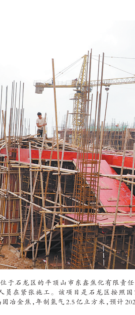
8月5日上午,位于石龙区的平顶山市东鑫焦化有限责任公司年产130万吨捣固焦热发电及制氢技改项目工地上,施工人员在紧张施工。该项目是石龙区按照国家环保超低排放标准于今年2月正式开工建设的,年产130万吨捣固冶金焦,年制氢气2.5亿立方米,预计2020年7月全面建成投产。
