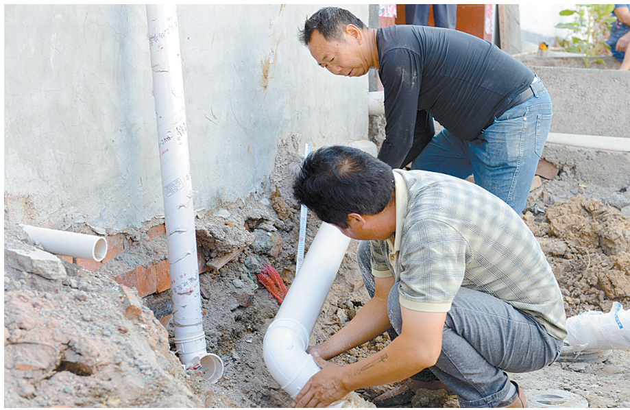
6月14日,工作人员在濮阳镇夏店村农户改厕施工现场安装管道。截至目前,示范区19个村的农户改厕工作全部进入收尾阶段。 本报记者 王尧 摄
