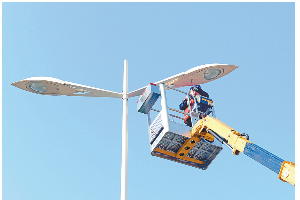
及时检修除隐患
