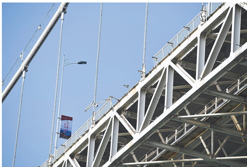
▲重庆万州公交车坠江事故现场的大桥护栏被撞出了一个豁口(10月28日摄)。新华社记者 王全超 摄
