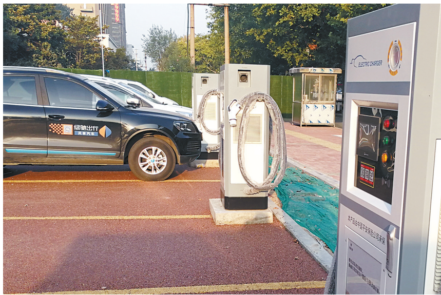
10月7日上午,市区建设路与迎宾路交叉口西侧路南的停车场,装上了多个新能源汽车快速公共充电桩。这是我市公共停车场首次配建新能源汽车快速公共充电桩,目前已经调试完毕(资料图片)。 本报记者 禹舸 摄
