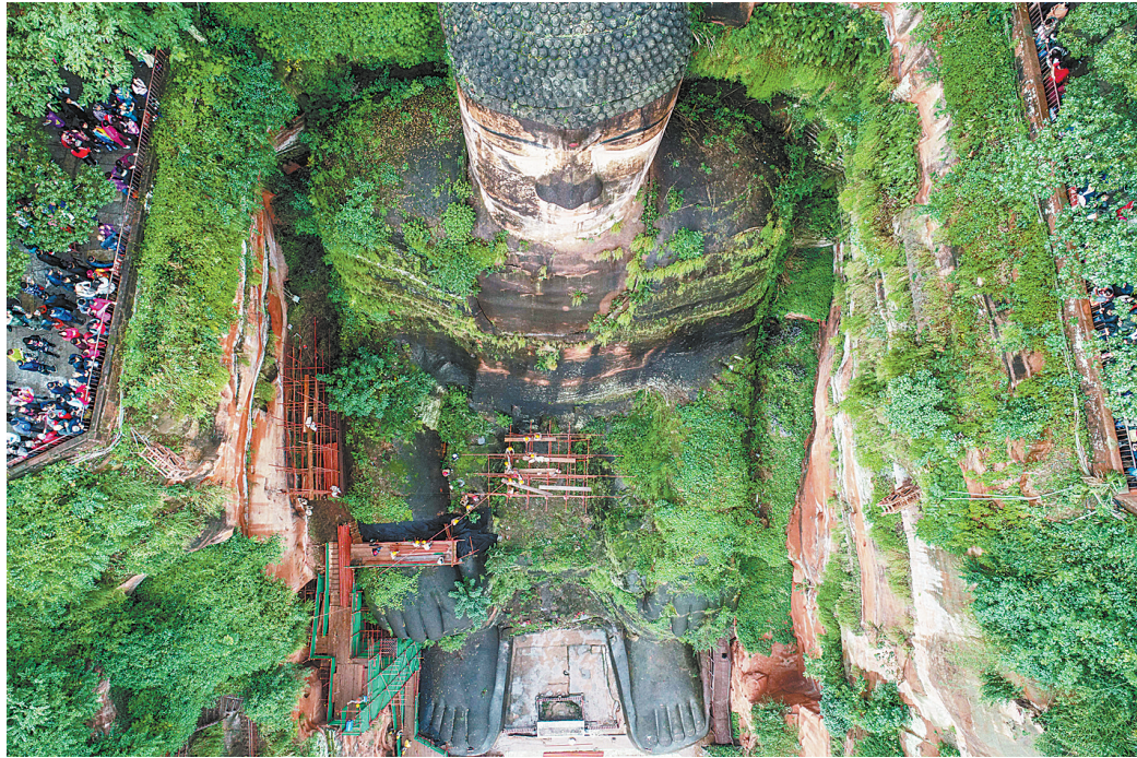
乐山大佛新世纪最大规模“体检”触达核心区域。游客在乐山大佛头顶部位,经过17天紧张施工,10月25日下午,正在“体检”的乐山大佛腹部以下的脚手架搭建完毕,这表明大佛“体检”已触达胸腹部及头部等核心区域。新华社发(陈昊翔 摄)
