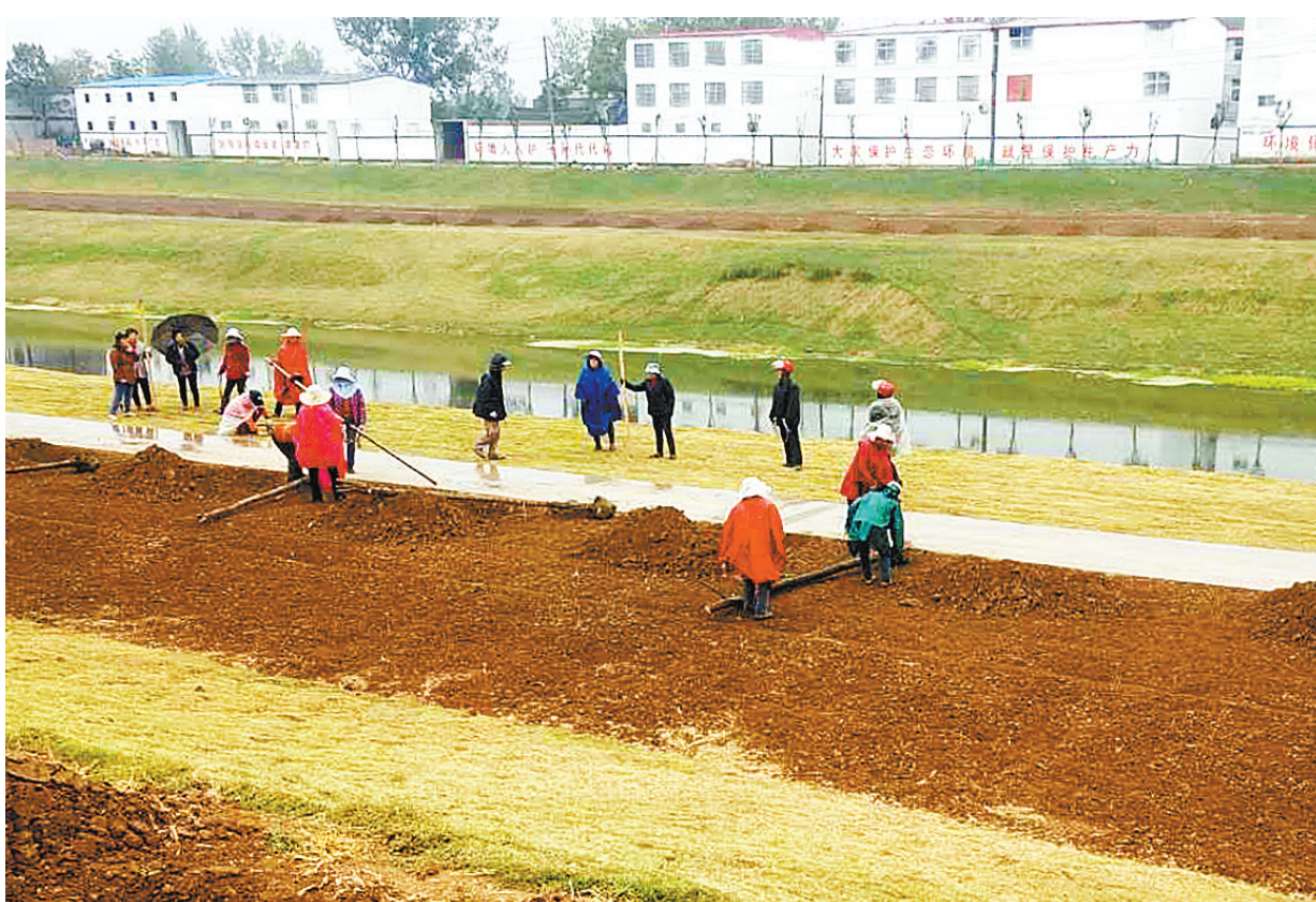
10月15日,工人在湛河综合治理工程白灌渠至张庄段景观绿化项目工地平整土地,准备栽种地被植物。
