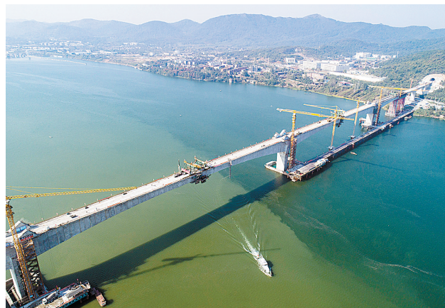
10月12日,崔家营汉江特大桥顺利合龙(无人机拍摄)。当日,位于湖北襄阳的
