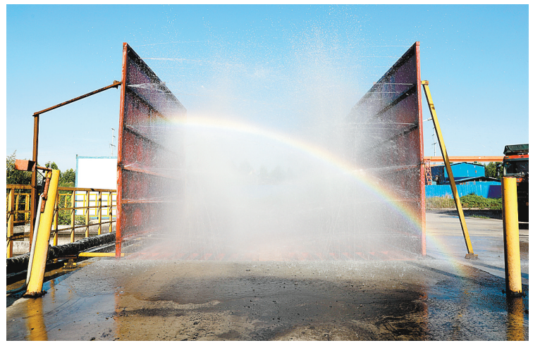
9月6日,尼龙科技公司全自动洗车设备正在运行中。该公司为保护企业周边环境卫生和园区整体环境卫生,耗资20多万美元安装了这套设备,用于对出厂车辆车厢、车轮上夹带的泥土、煤炭等附着物进行冲洗,杜绝车辆箱体和轮胎沾着附着物上路。洗车用水经净化池处理后的生产过程中产生的废水,并且洗车用水经过沉淀池、过滤池沉淀、过滤等净化处理后,循环使用。 张玉琴 摄
