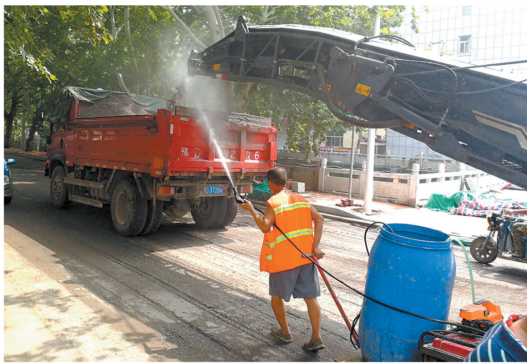
8月6日,施工人员在市区迎宾路改造现场一边施工,一边喷淋降尘。为更好环境污染防治工作,市市政工程公司路桥处在迎宾路改造工程施工现场安置移动喷淋系统进行喷淋降尘,避免扬尘造成环境污染。 本报记者 姜涛 摄
