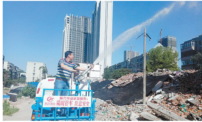
6月5日下午,新华区光明路街道安排洒水车对市委家属院拆迁工地进行洒水、抑尘。 本报记者 毛玺玺 摄
