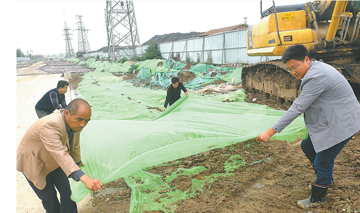
5月22日,施工人员在湛南路西延项目施工现场更换防尘网。为了做好环境污染防治工作,施工方积极更换破损防尘网,避免黄土裸露造成风扬尘。
