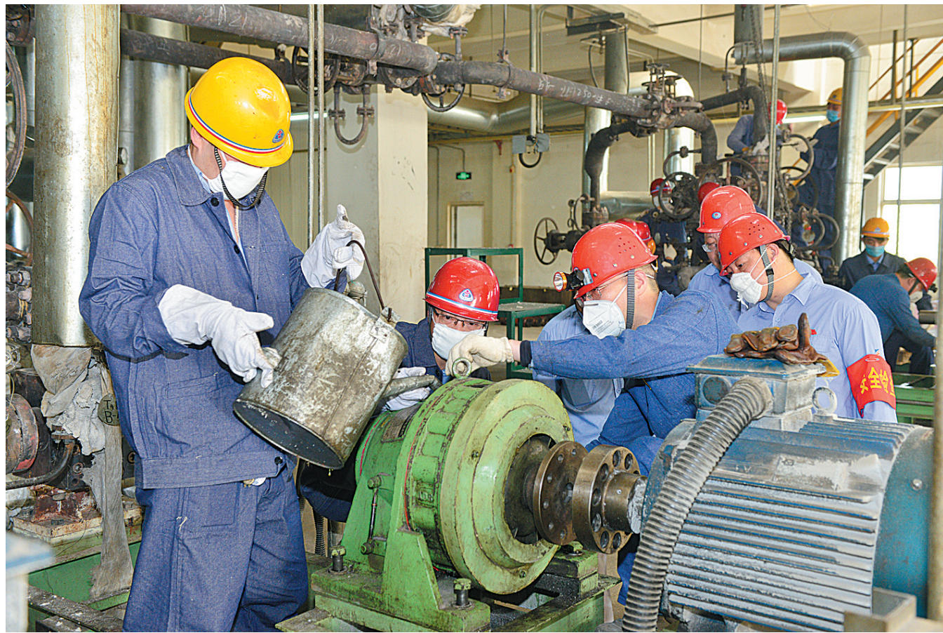
4月9日,大修人员在对设备进行拆解。当日,帘子布公司2018年度原丝一厂11、12系列停车检修拉开帷幕。原丝一厂坚持“安全第一”的指导思想,把安全工作落实到检修的每一个环节,从厂长到员工自觉把自己当作安全监督员,调动参检人员的主观能动性,各个工段合理调配人员,严肃、认真、细致地对
