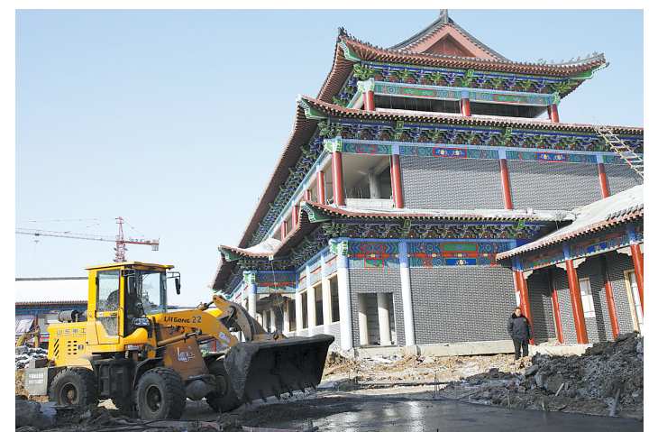
1月29日上午，工人在宝丰县刘兰芳艺术馆施工现场紧张施工。该项目自2016年10月开工建设以来，经过紧张施工，目前艺
