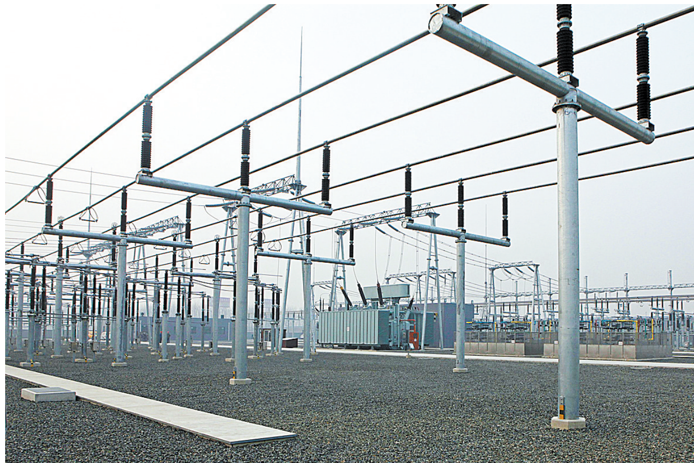
▲12月28日上午,鲁山县220千伏望城变电站成功投运。
