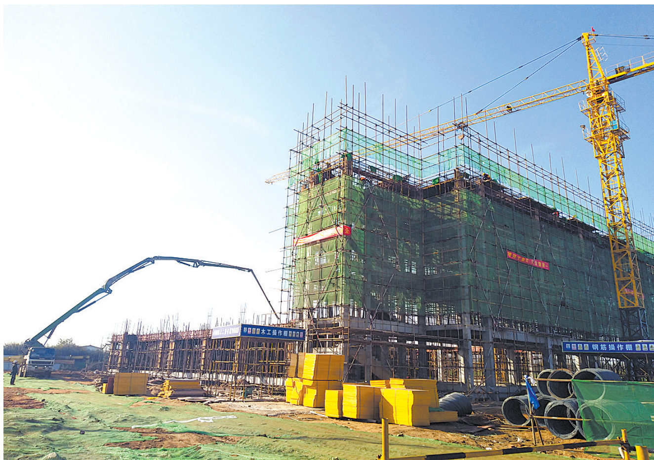
11月23日,工人们在鲁阳中学(鲁山一中分校)施工工地加紧施工。该项目位于尧山大道以南,钢厂路以西,设计规模为24班,总建筑面积为15989.99平方米。
