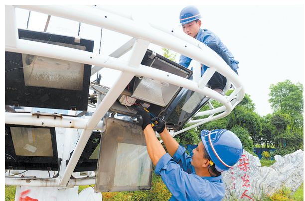
9月19日,技术人员在宁洛高速公路附近升级改造高杆景观灯。
