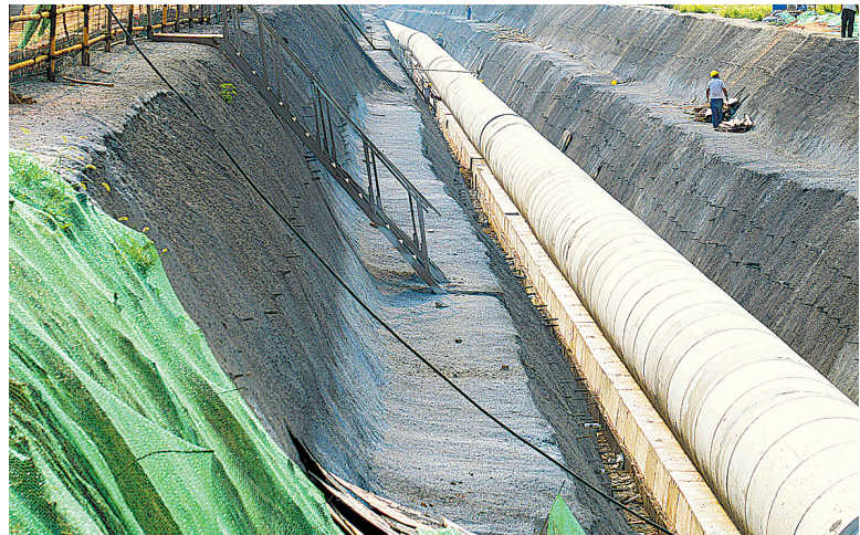
9月7日,位于开发二路湛河桥西侧的湛河综合治理工程新建湛北干管工地对管沟立面实施喷浆硬化,并用防尘网对裸土进行覆盖。为做好环境污染防治工作,湛河综合治理工程新建湛北干管建设单位对管沟立面实施喷浆硬化,并用防尘网对工地内部裸土进行覆盖,努力消除建筑扬尘隐患。
