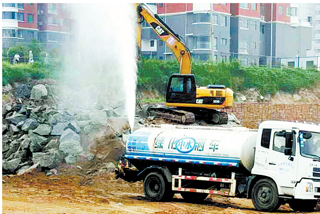
8月14日,在乌江河公园工地,施工人员驾驶洒水车配合挖掘机开展“湿法作业”。为做好环境污染防治工作,该项目建设单位按照“湿法作业”要求,组织洒水车在土方开挖现场同步实施洒水雾抑尘作业,努力抑制建筑施工扬尘污染。本报记者 王尧 摄
