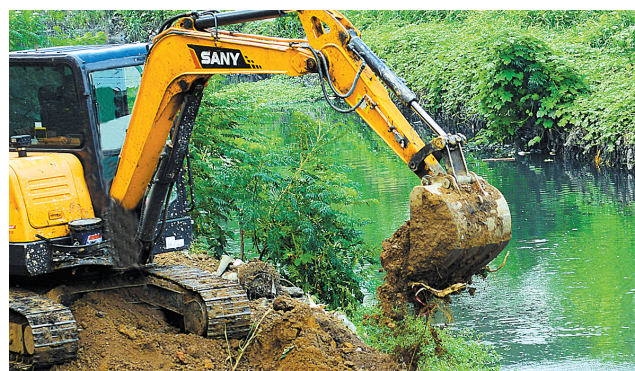
7月22日,施工人员在吴寨沟截污管道改造现场驾驶挖掘机作业。吴寨沟是淇河沿岸18条支流之一,吴寨沟治理项目包括河道清淤、
