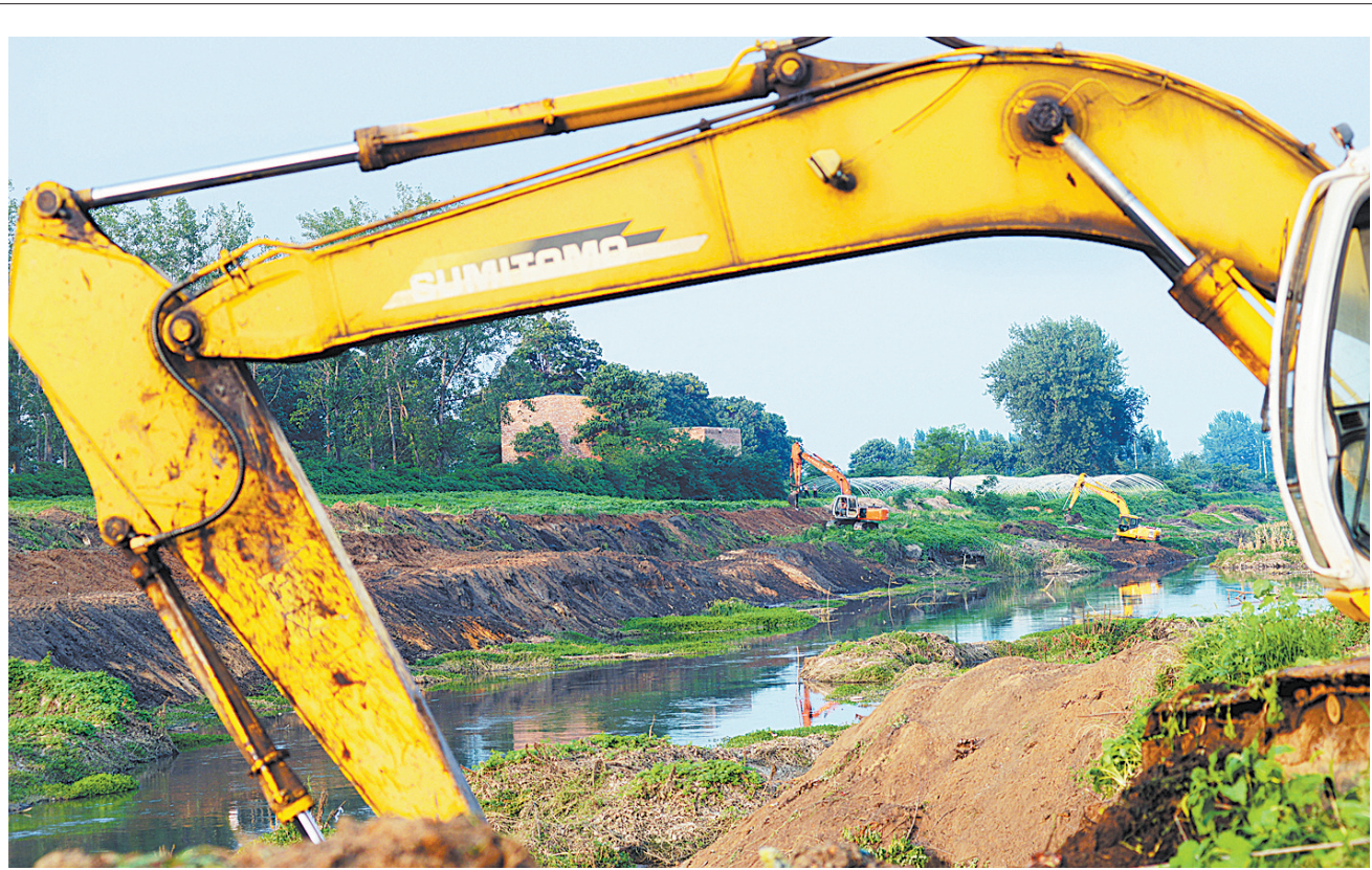
7月17日,施工人员驾驶挖掘机在白灌渠至张庄河段河道综合治理工程河道治理最后一批项目之一。该项目建设单位增派机械、人员,同时在河道两岸分段施工,努力确保项目今年底如期竣工。本报记者 王尧 摄
