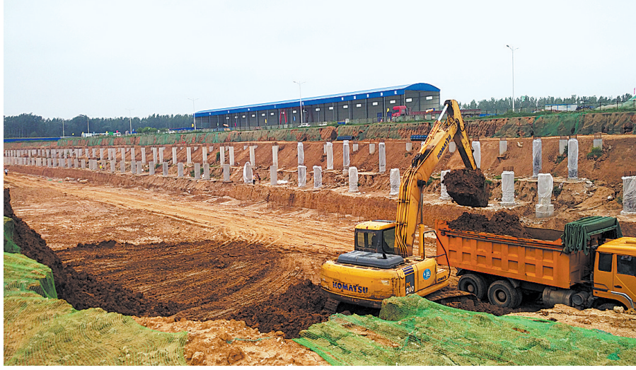
在叶县港区北码头施工现场,挖掘机、渣土车正在清理土方。程颖 摄
